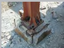
Fig.2 - Corrosão das armaduras de um apoio.
