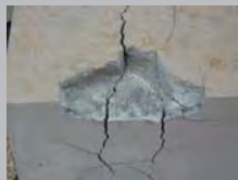
Fig.3 - Fissuração de um maciço de betão.
