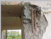
Fig.1 - Esmagamento da cabeça de um pilar.
