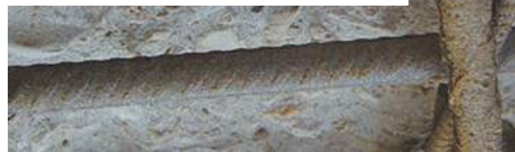
Aspeto das armaduras após decapagem View of reinforcement after scouring
