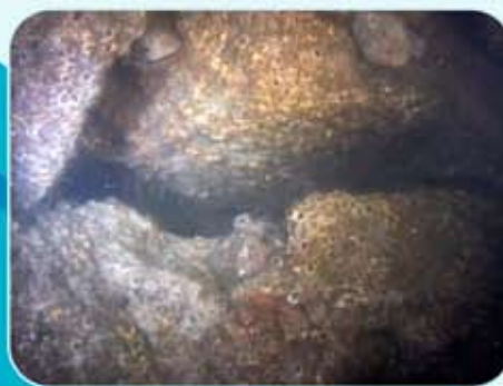
5 - Degradação do betão armado. Reacção álcali-agregado, nos pilares da Ponte da Figueira da Foz
