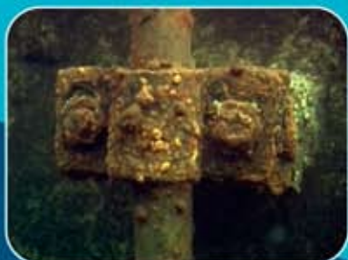
1, 2, 3 e 4 - Anomalias Barragem do Viriato: guia de tomada, grelha, cunha de válvula e furo de condução de haste
