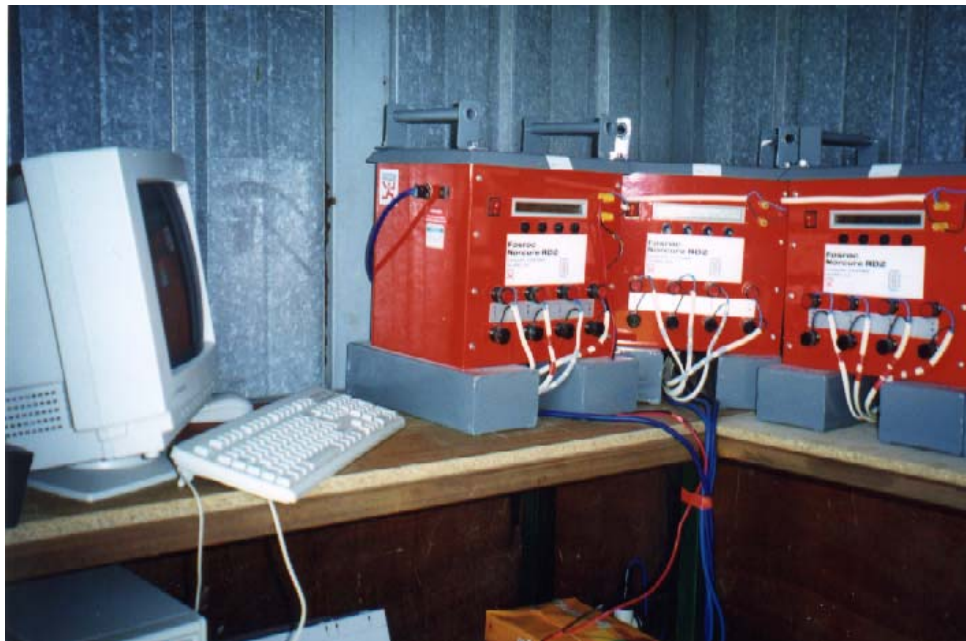
Fig. 2 - Unidades RD2 rectificadoras de corrente e de controlo automático.
