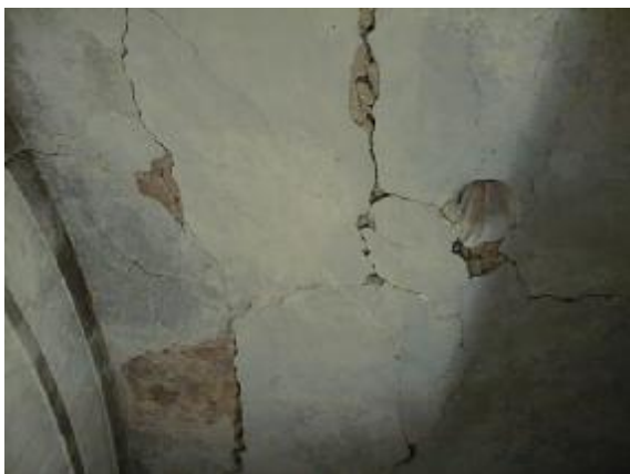
Figura 8 – Fendilhação no intradorso da abóbada de berço
