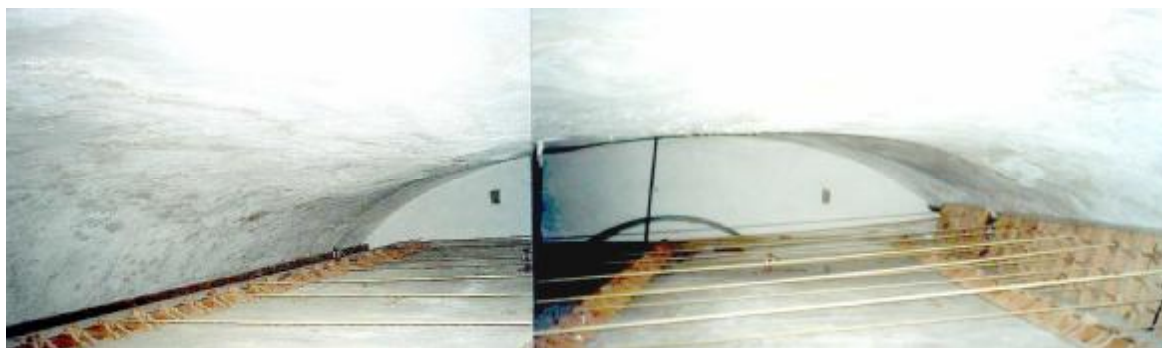
Figura 7 – Deformações na abóbada, pelo intradorso, zona do palco
