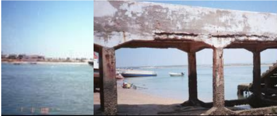
Figuras 5 e 6 – Ponte de acesso à Ilha de Faro e Desembarcadouro da Porta Nova, em 1990
