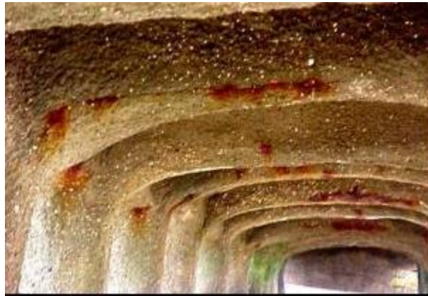
Figuras 21 e 22 – Evidência de corrosão em elementos estruturais da obra 1 (2000)
