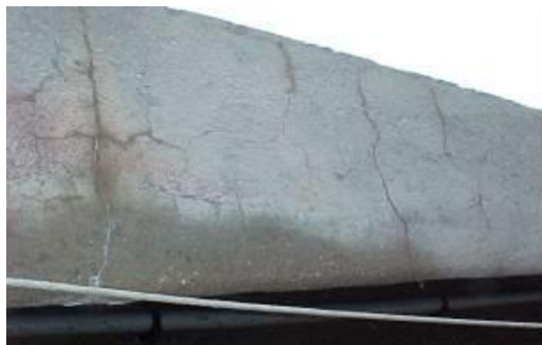
Figuras 28 e 29 – Fendas na laje e fissuração superficial do betão, por retracção
