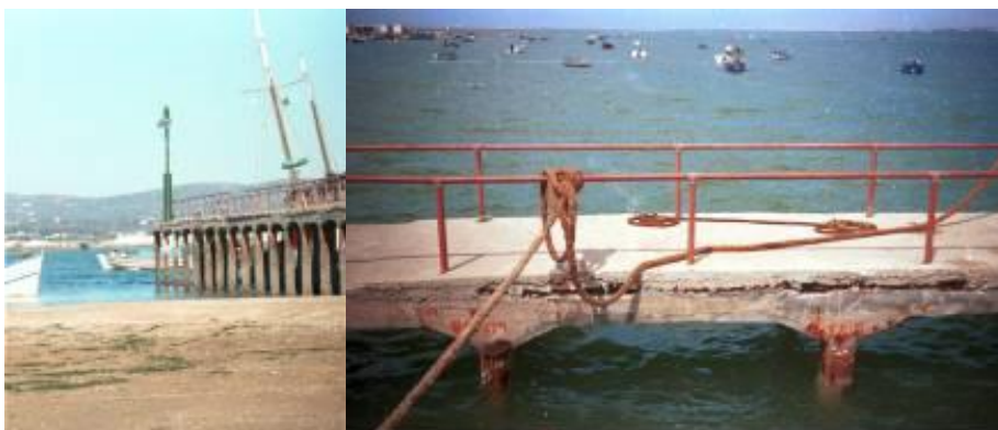
Figuras 1 e 2 – Vista lateral da obra n.º 1 e pormenor da degradação existente em 1986
