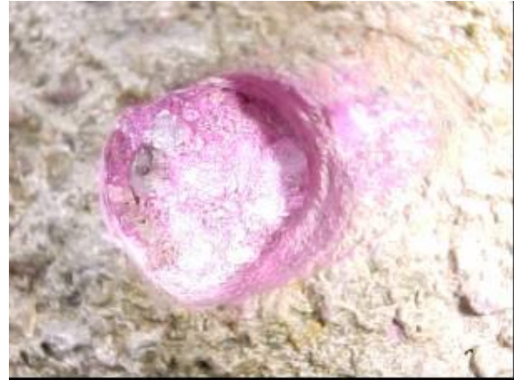
Figuras 27 – Ensaio de carbonatação na obra 4
