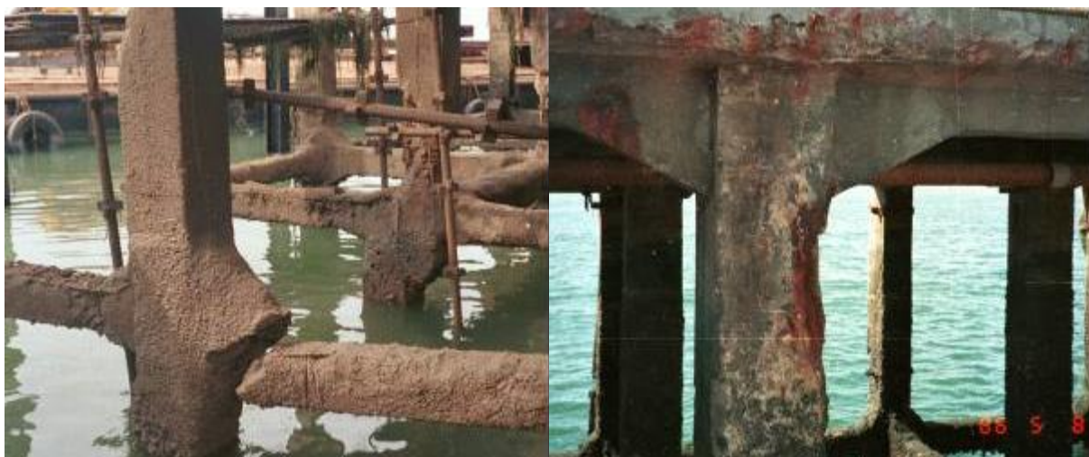
Figuras 3 e 4 – Pormenores da degradação existente na obra 2 em 1986
