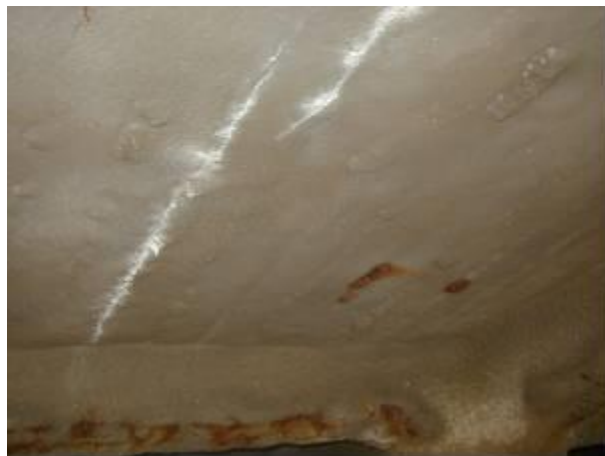
Figuras 25 e 26 – Estribo dos pilares à vista e fenda na laje
